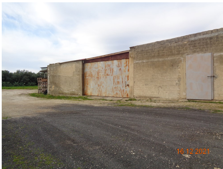
Prospetto est (ampliamento difforme dal progetto autorizzato)
